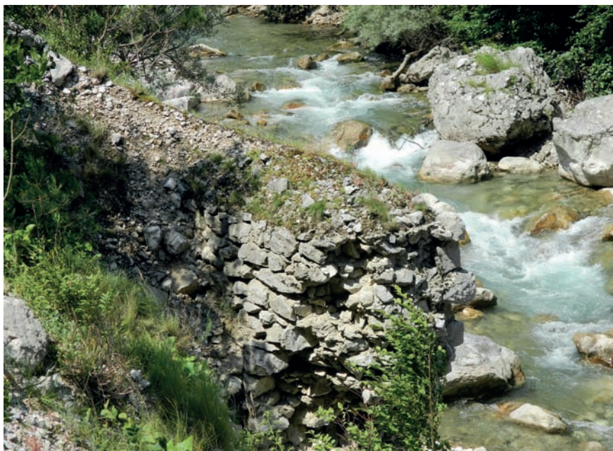
Sl. 8. Skliznuti dio nekoga zida uz samu rijeku (foto: Nina Čuljak)
