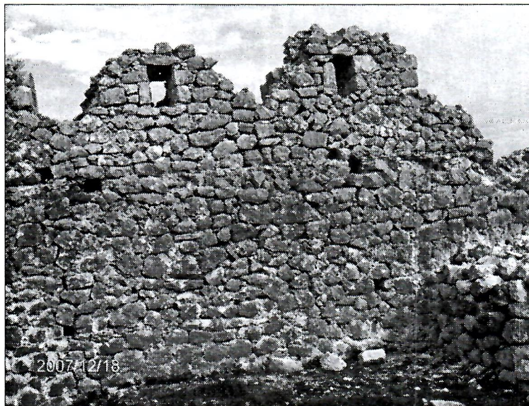
Sl. 15. Prikaz oštećenja krune zidova.
