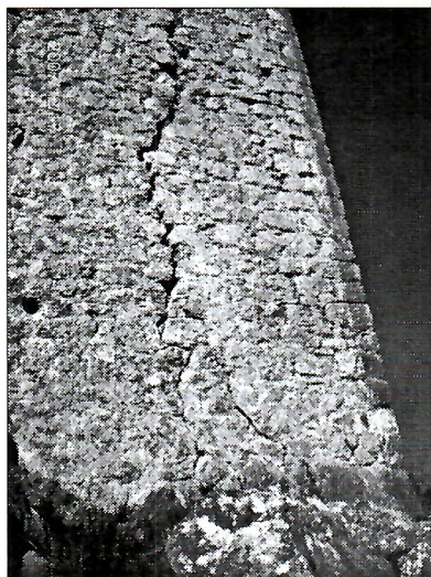
Sl. 10. Izražena pukotina na zidu 2 - pogled s vanjske strane.
